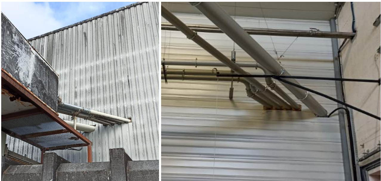
Figure 14 : Canalisations de récupérations des déchets de découpages
