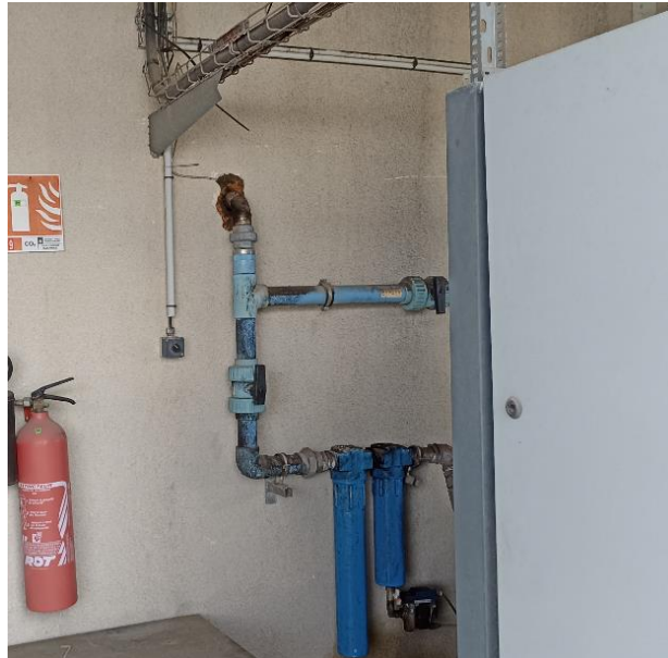
Figure 11 : Canalisation air comprimé à mettre à la terre.
