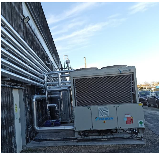
Figure 10 : Canalisations issues de la PAC
