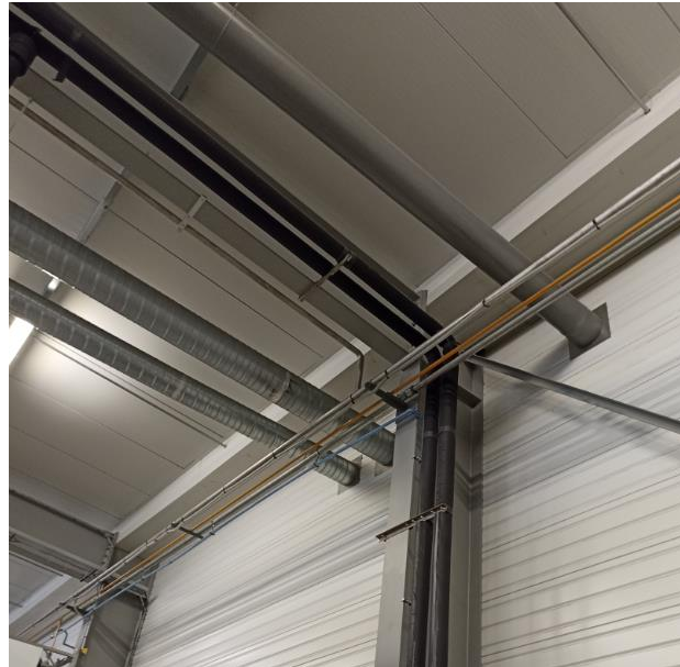
Figure 13 : Canalisations issues de l'imprimerie NOVOFLEX
